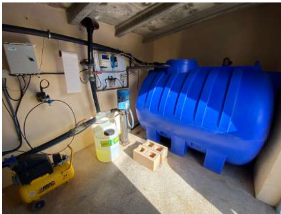
7 - Dipòsit cloració Ses Mosqueres
